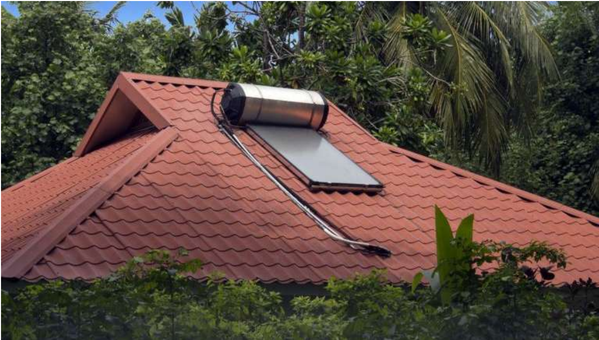
Figura 4 – Aquecedor solar de água residencial ou comercial
