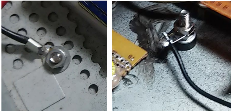
Figura 71 - Detalhe da ligação ao aterramento na caixa metálica.
